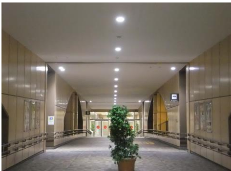
北棟と南棟の連絡通路 200φ防湿型LED照明 LZD60798NW + リニューアルプレート
